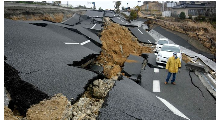
Depremler sonucu çöken yollar
